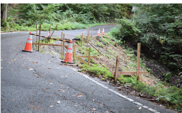
古口林道災害箇所
