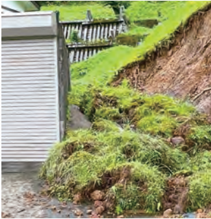
綱取の土砂災害力所
