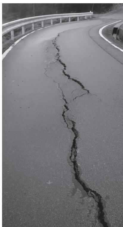
崩壊が心配される村道 12月現在
