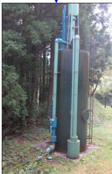
急速ろ過装置
