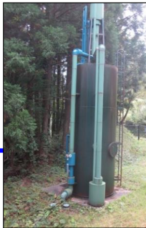
急速ろ過装置
