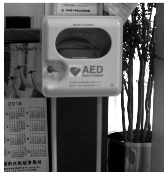
役場内に設置してあるAED
