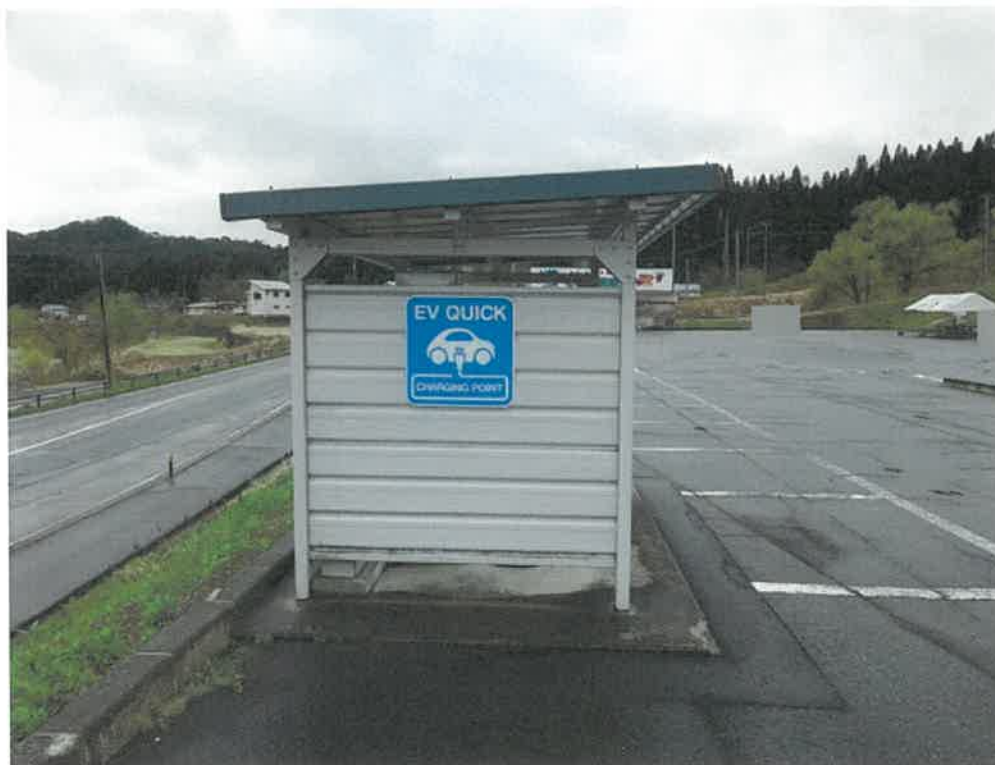
既存EV充電設備側面
