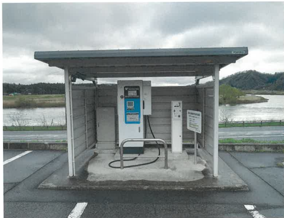
既存EV充電設備正面
