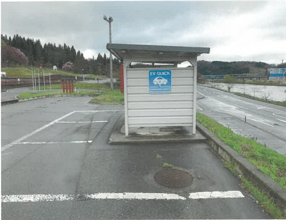
既存EV充電設備側面
