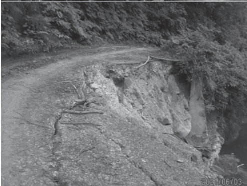
被災した危険な道路
