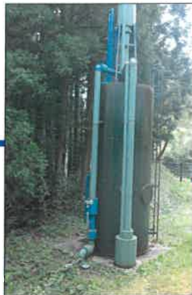
急速ろ過装置
