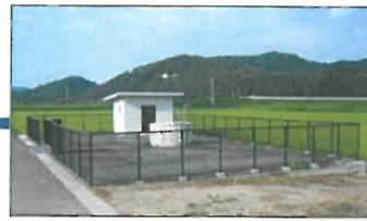
第2取水ポンプ場 及び第2取水井
