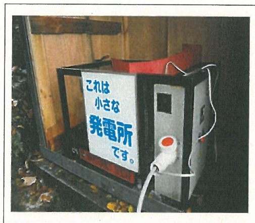
写真 8-16 小規模水力発電「発電機」 （飯豊町での実証実験風景より）
